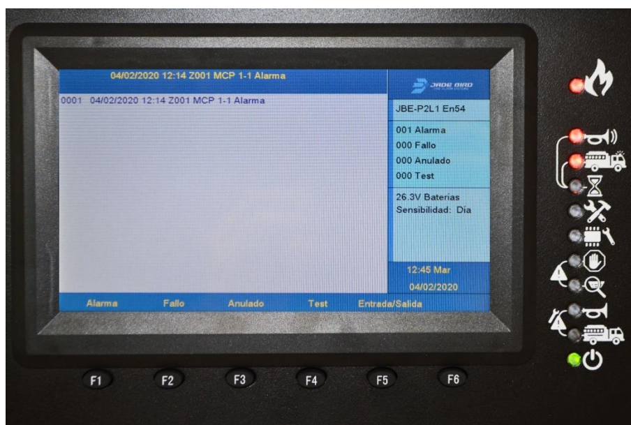
Figura 20: La pantalla de alarma
