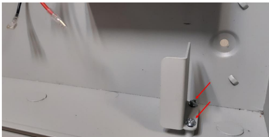
Figura 7: Soportes de soporte de batería
