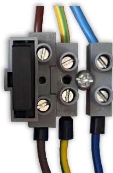
Figura 5: Conexiones de red
